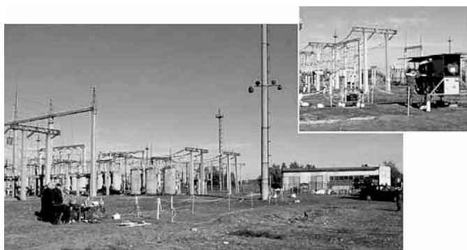
Рис. 3. Эксперименты на действующей подстанции
